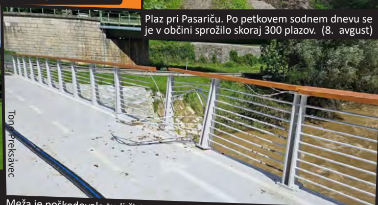
Meža je poškodovala tudi čisto novi kolesarski most pri Džungli. (8. avgust)
